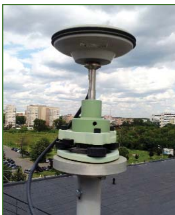
Рис. 2 Антенна ГНСС, стационарно установленная на референционной станции СТП МОБТИ
